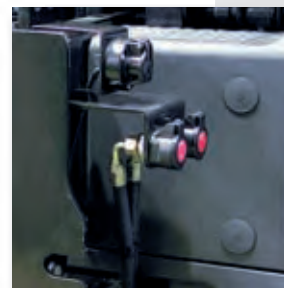
Электрические и гидравлические соединения
